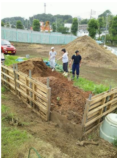
立派な堆肥場も完成です
